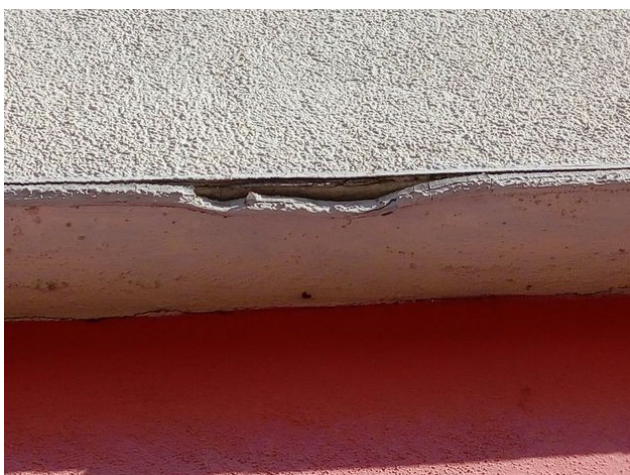
foto/31/ Pohled na trhlinu v základacím profilu ETICS
