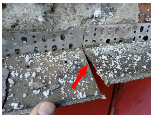
foto/34/ Pohled na základací profil – absence plastové spojky mezi profily
