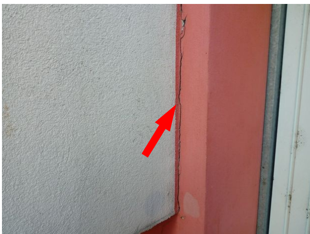
foto/29/ Pohled na trhlinu u navazující konstrukce ETICS
