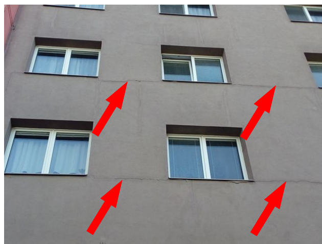
foto/26/ Pohled na horizontální trhliny v místě rohů okenních otvorů
