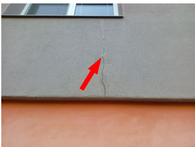
foto/27/ Pohled na vertikální trhlinu v místě založení ETICS
