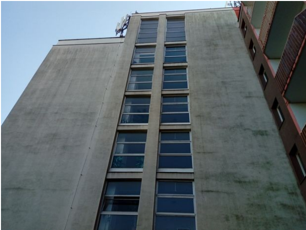
foto/35/ Pohled na biotické napadení severní fasády
