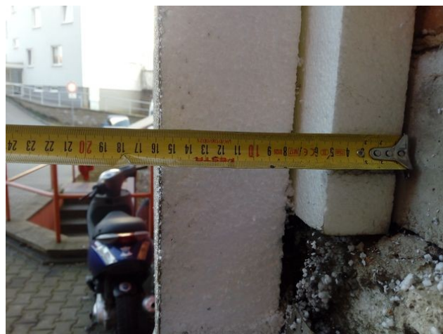
foto/20/ Pohled na lokální tloušťku souvrství ETICS v místě kotvy – efektivní kotevní hloubka &lt; 10 mm
