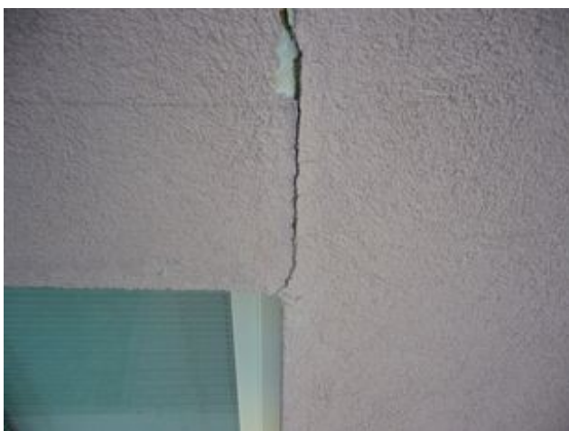
foto/25/ Pohled na vertikální trhlinu v místě rohu okenního otvoru
