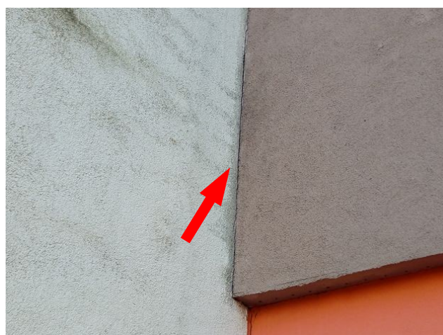
foto/28/ Pohled na trhlinu u navazující konstrukce ETICS
